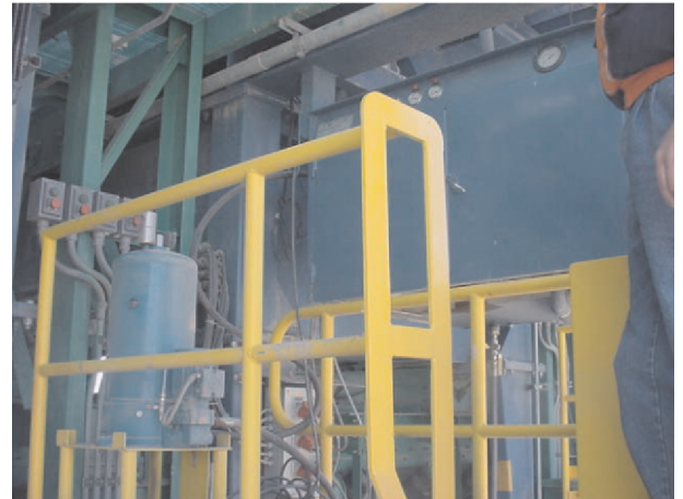
Crusher No 2 - Lubrication Tank. Minera El Tesoro, Chile.
